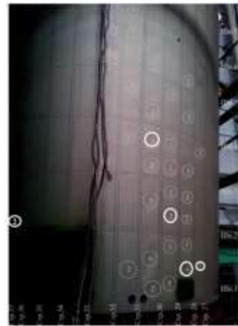
Рисунок 6 – Деформації обшивки корпусу міжступеневого відсіку у вигляді «хлопунів» між площинами II и III
