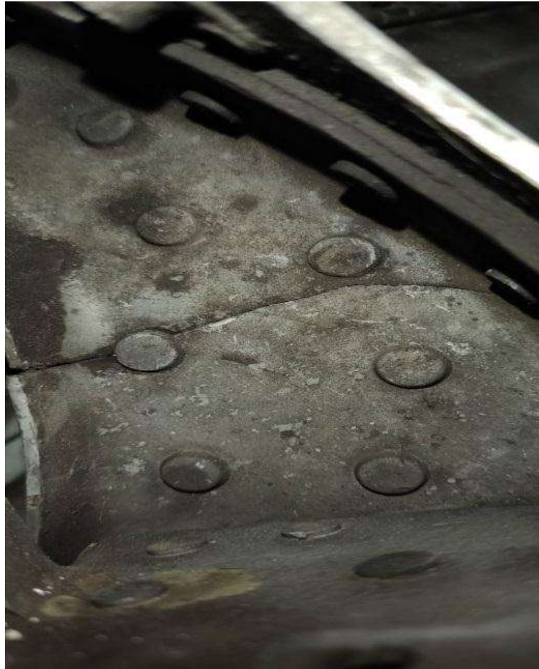
Рисунок 1.3 – Втомна тріщина шпангоуту фюзеляжу
